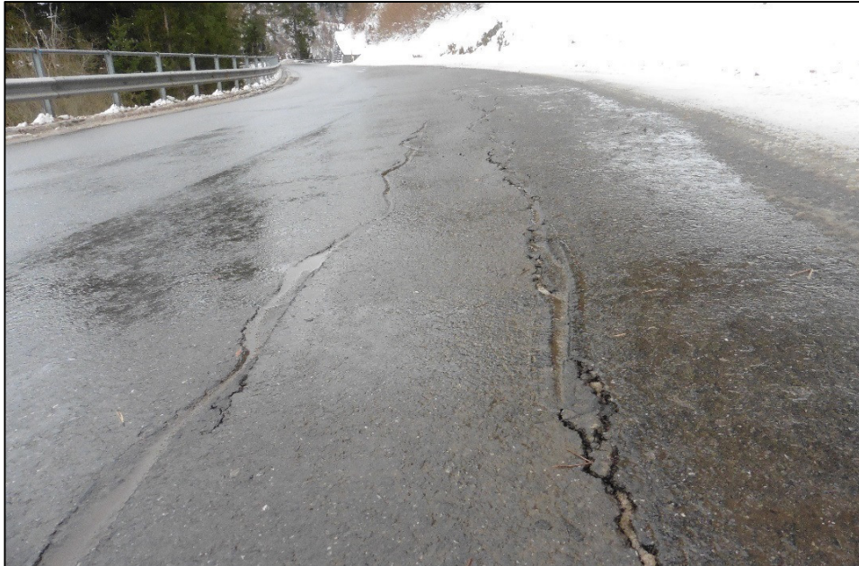
Abb. 1: Jährlich hinter der Lehnenbrücke Sandkehr West sich öffnende Risse.
