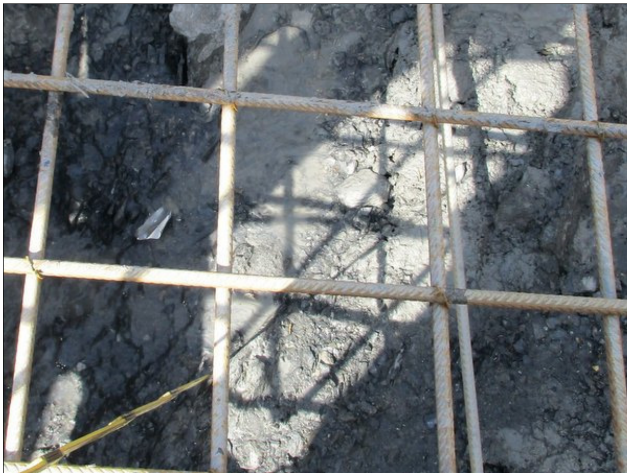
Abb. 7: Wasseraustritte unter Gründungssohle Dichtriegel bei Entnahmebauwerk
