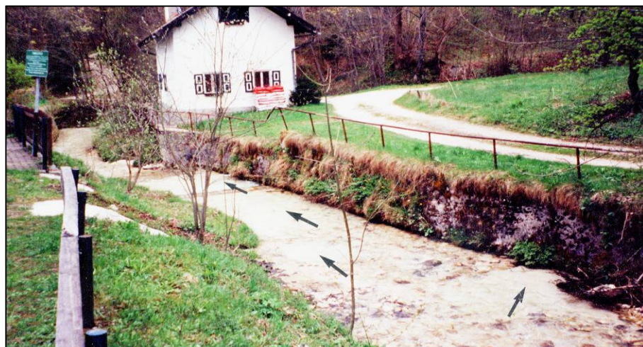
Abb. 3: Weißbach vor der Mündung in den Mesnerbach mit Wasseraustritten aus der Sohle (8) mit Erdfällen und starke, getrübbte Austritte an der Sohlschwelle (9) und der Auslauf der „Drainage Pliem“ (10).
